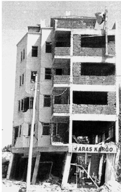
شکل ۱۲-۴ خسارات ناشی از طبقه نرم.
